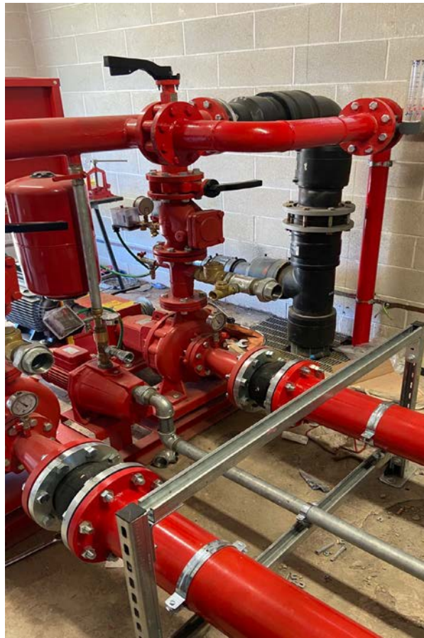
Il nuovo impianto antincendio cabina nord a porto Margreth
