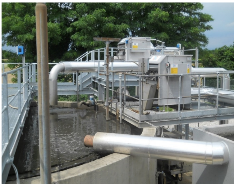
Impianto di depurazione ZIU: sezione di pretrattamento acque reflue industriali in ingresso
