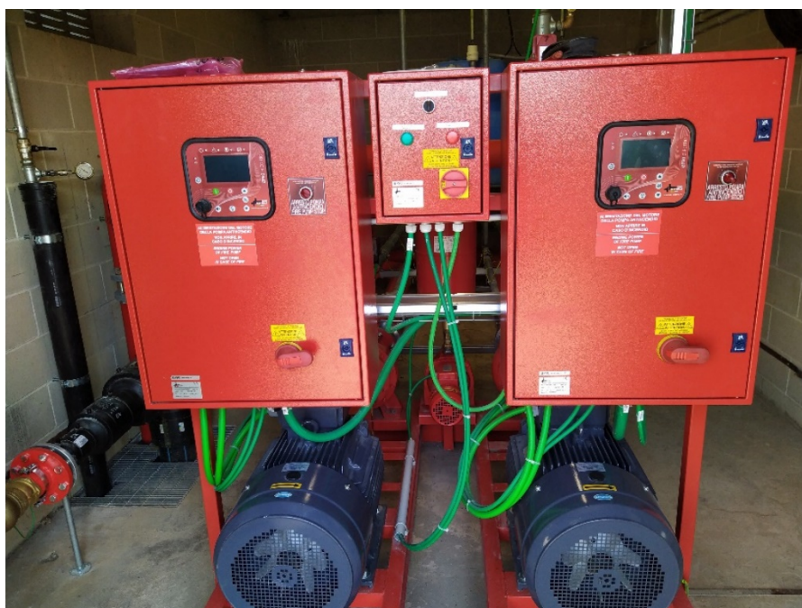
Le nuove pompe antincendio cabina nord a porto Margreth
